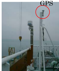
コンパスデッキ上に設置されたGPS
